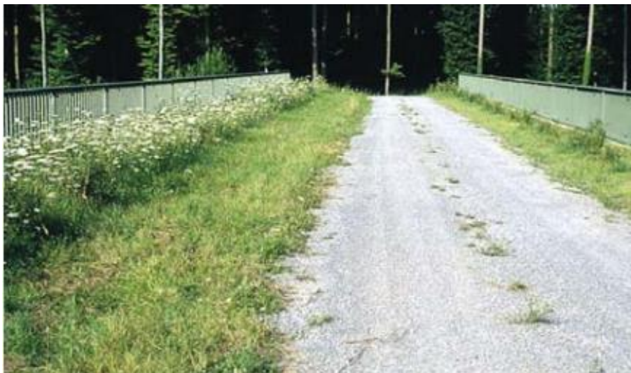
Figure 45 : Pont sur ILT aménagé avec une bande enherbée. Source : Setra : Faune et trafic, 2007..
