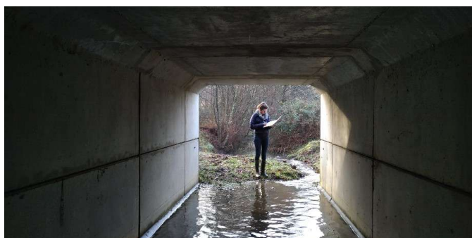
Les ponts, buses, dalots et ponceaux peuvent jouer un rôle majeur dans la transparence écologique du réseau primaire s'ils possèdent des caractéristiques adaptées.
